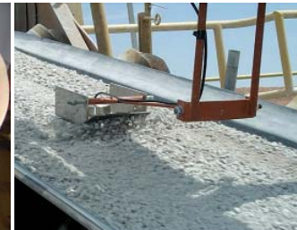
Sensor Litronic-FMS II im Gleitschuh- schlitten eingebaut am Förderband.
