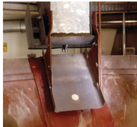
Sensor Litronic-FMS II in Materialrutsche eingebaut.
